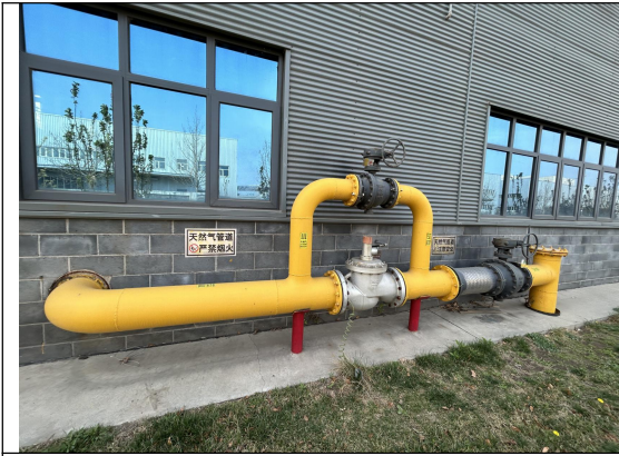
锅炉房外天然气管道电磁阀及手动阀
