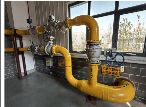
锅炉房天然气管道截止阀
