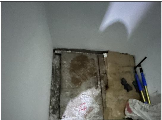
事故应急水池
