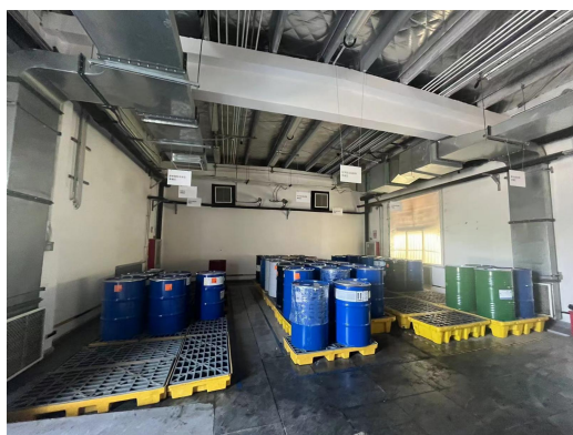
危险废物暂存间（内部）
