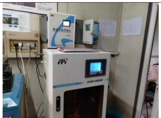
厂区废水总排口在线监测设施
