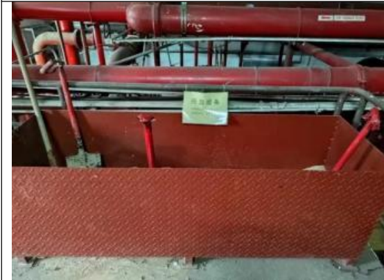
消防沙箱及消防铲
