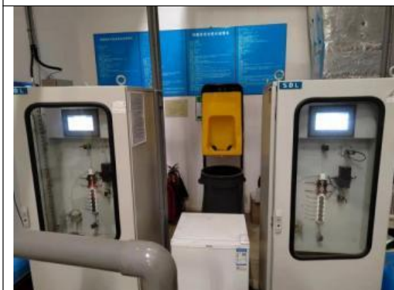
厂区北侧污水处理站在线监测设备
