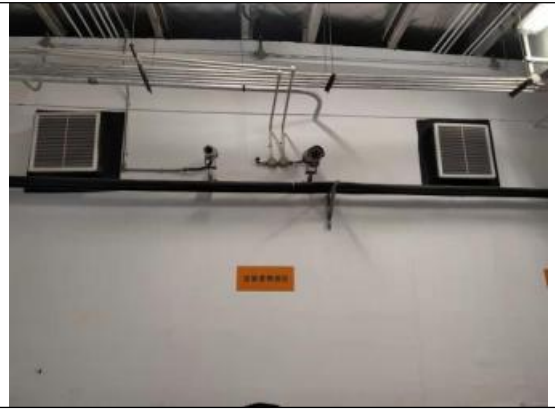
危险暂存间视频监控系统
