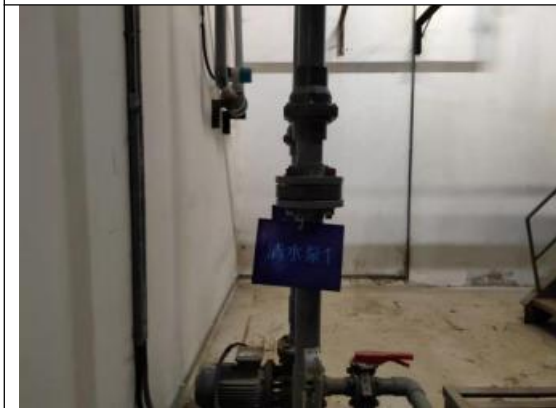
厂区北侧污水处理站清水泵
