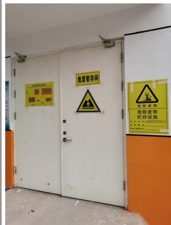
危废暂存间标志牌
