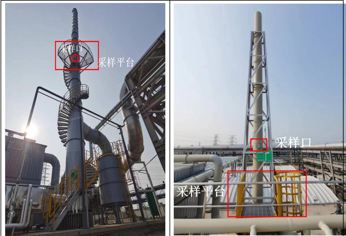
废气排放口标志牌 (P3)
