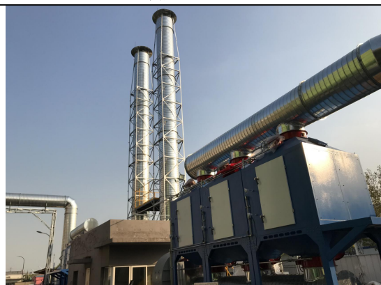
图 3 废气排气筒 DA001（左）、DA005（右）
