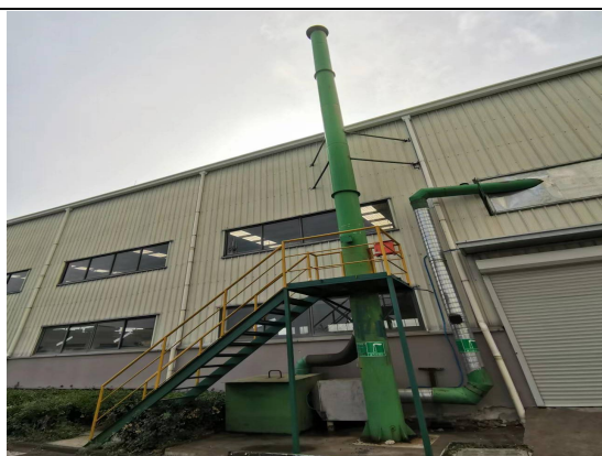
图 8 模型加工废气治理设施及排气筒 DA003
