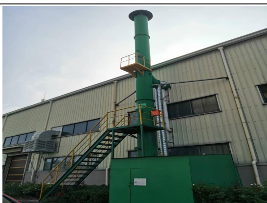
图 7 模型喷涂废气治理设施及排气筒 DA002
