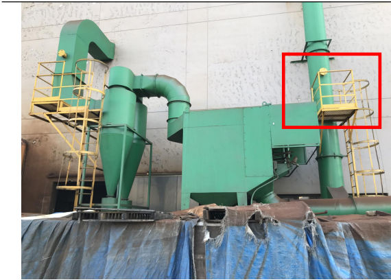
图 9 DA008 采样平台及采样口
