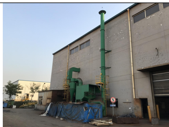
图 6 清理工序废气除尘器及排气筒 DA008
