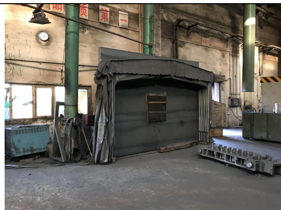
图 4 后处理清理工序废气收集装置
