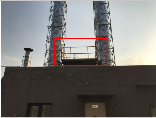
图 6 DA001 及 DA005 采样平台及采样口
