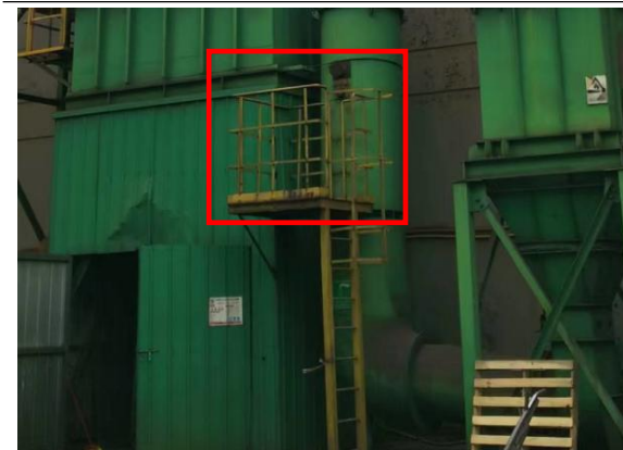
图 15 DA007 采样平台及采样口
